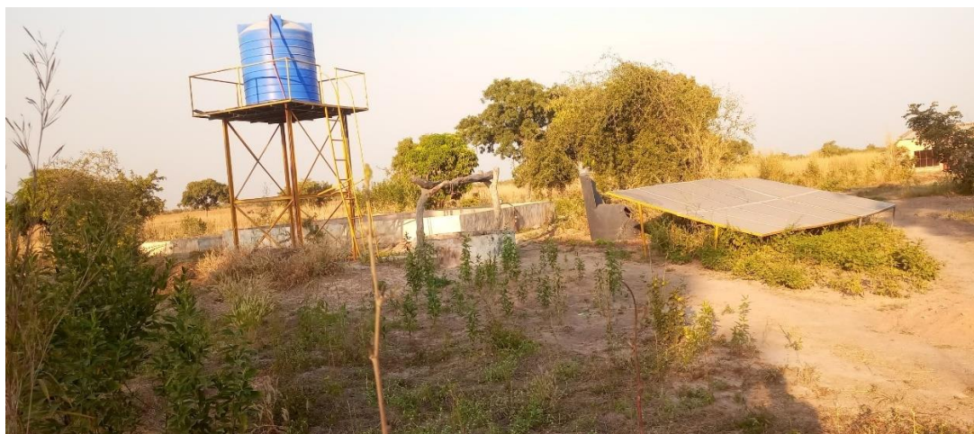
Figure 16: Forage équipé de réservoir et de système solaire dans un périmètre maraîcher à Koussanar
